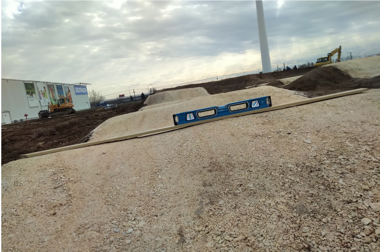
20. ábra: A burkolat oldalesése kb. 2,5% mértékű
