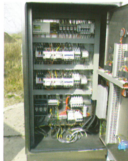
Elektromos szekrény felújítást követően
